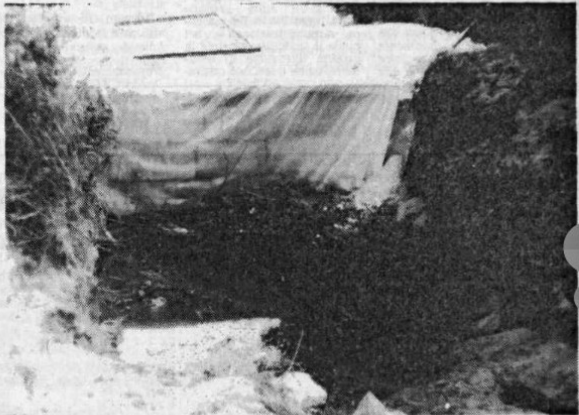
La fogna a cielo aperto di Porto Cesareo. Un serbatoio di infezioni. Dice il pretore Sodo: « Devono cominciare i lavori per la fognatura a partire dal 18 giugno. I soldi ci sono, quindi... »
